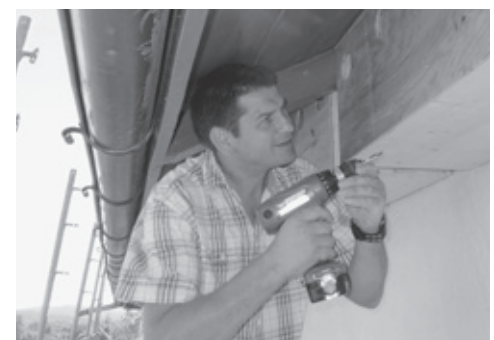
Marco Jacober, Schlosswart auf der Mörsburg in Oberwinterthur, beim Anbringen neuer Dohlen-Nistkästen am 3. September 2013. (Bild: Orniplan AG)
