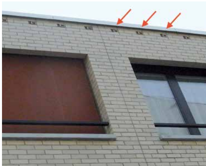
So dezent können Mauersegler-Nistkästen in einer Fassade eingebaut werden.
